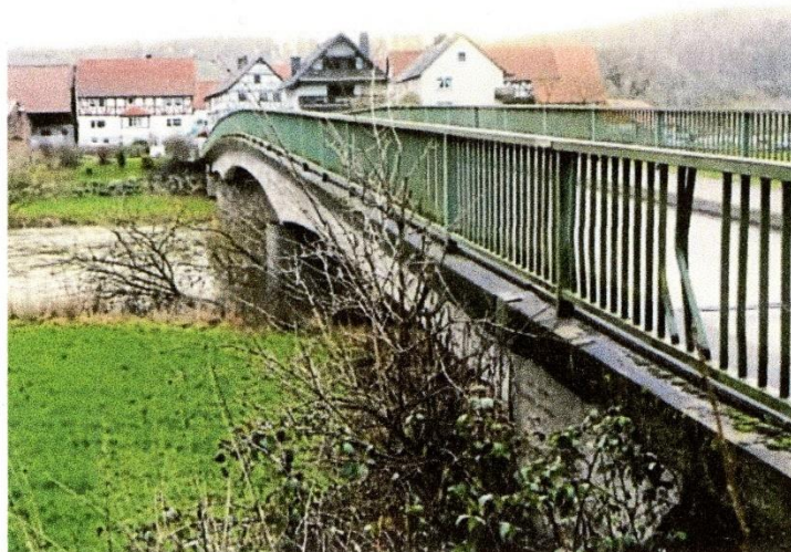
Sie wird bald ersetzt: Die Brücke in Büchenwerra soll im Sommer abgerissen werden. Anschließend wird eine neue Brücke gebaut.
