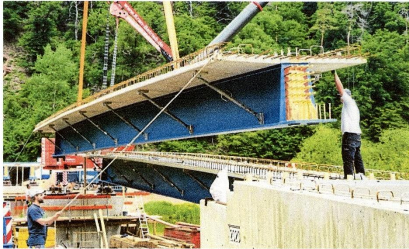
Montage des letzten kurzen Brückenteils: Danach war Schluss. Denn die übrigen, zwei langen Teile, kamen gestern nicht an der Brückenbaustelle an.
