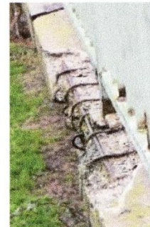
Schlechter Zustand: Der Beton bröckelt.
